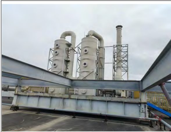
现有废气喷淋塔
